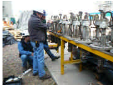
Calibración Termocupla en Quemadores
